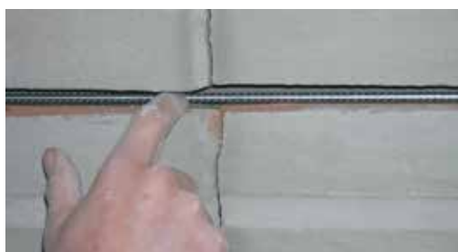
Sætningsrevner kan nemt og effektivt udbedres med Skalflex® Armeringssystem.
