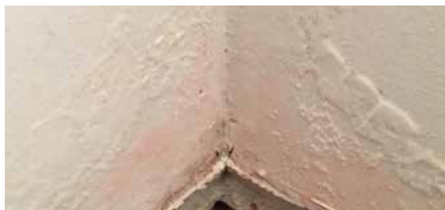
Salte, der krystalliserer sig på overfladen, nedbryder bygmateriale. Puds og mørtel vil miste styrke og vedhæftningsevne, og blive sandagtig.
