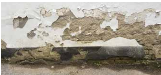
Eksempel på opstigende grundfugt, der har medført at maling og puds falder af.
