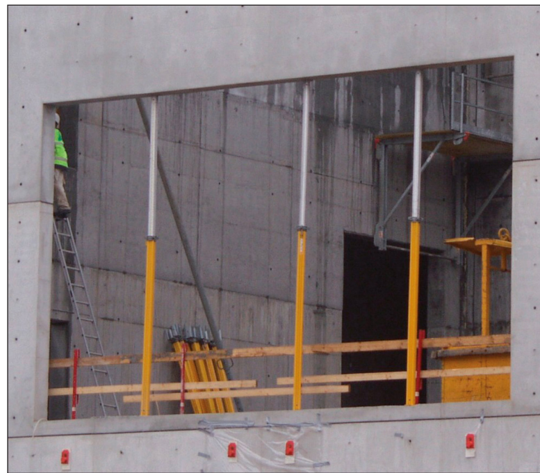
Vent med montering af vinduer til al beton- og mørtelarbejde er udført.
